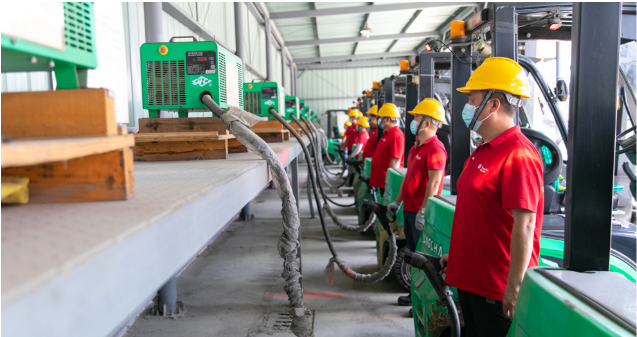
电叉车充电桩
