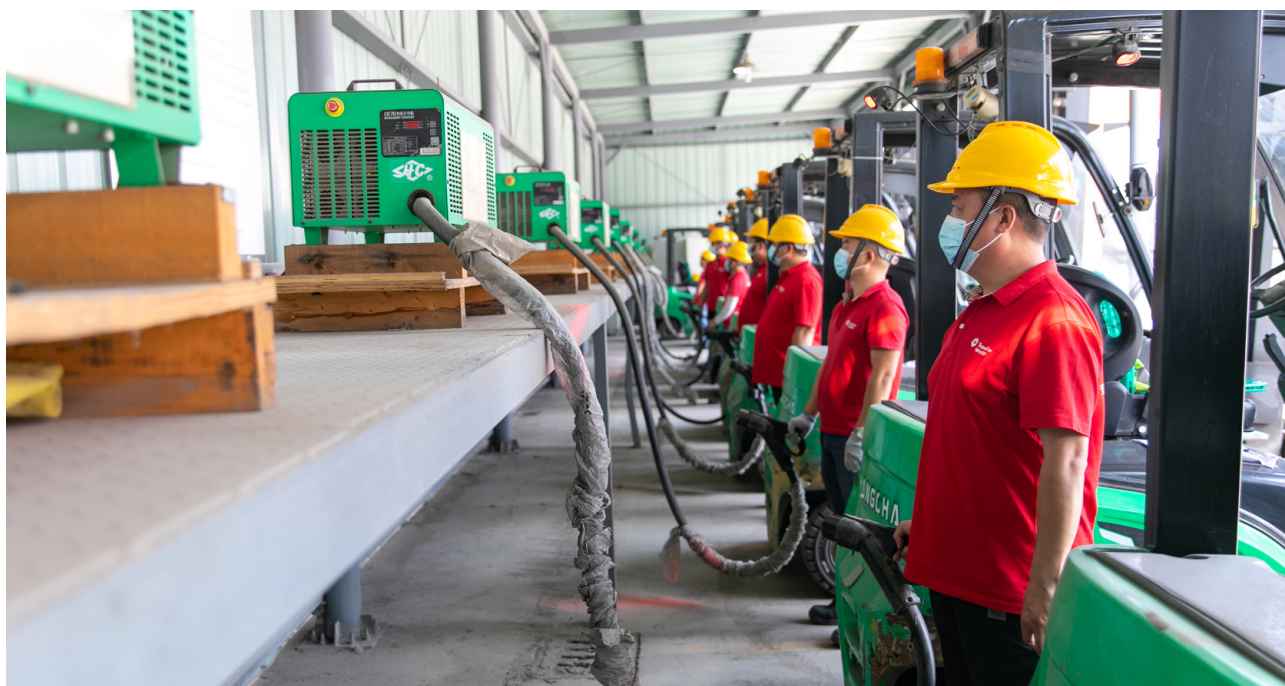
电叉车充电桩
